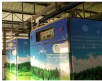
ระบบไอโซนสำหรับปรับปรุงคุณภาพน้ำ เพื่อการบำบัดน้ำเสีย
